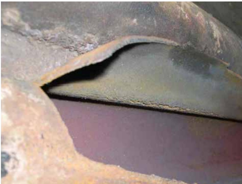
Figura 6.18 – Falha por corrosão/fadiga em tubo de caldeira
