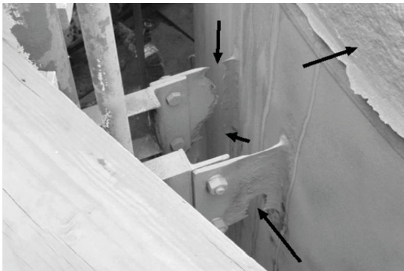
Figura 6.10 – Corrosão sob isolamento no suporte de fixação de tubulação no tampo do vaso
