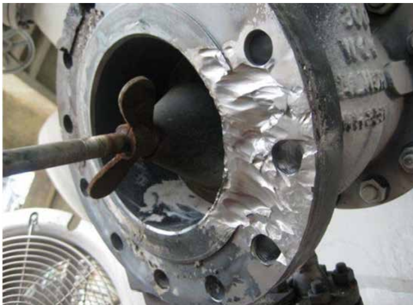
Figura 6.12 – Corrosão/erosão de um flange em aço 1 1/4 Cr – ½ Mo, 136kgf em uma linha da unidade de craqueamento catalítico fluido
