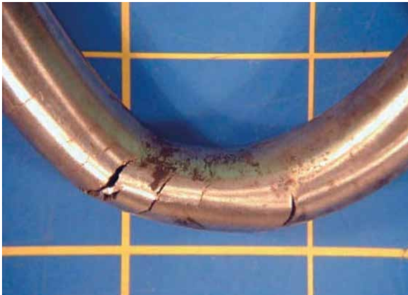
Figura 6.23 – Trincas externas de tubo de instrumento em aço inoxidável 304 sob isolamento
