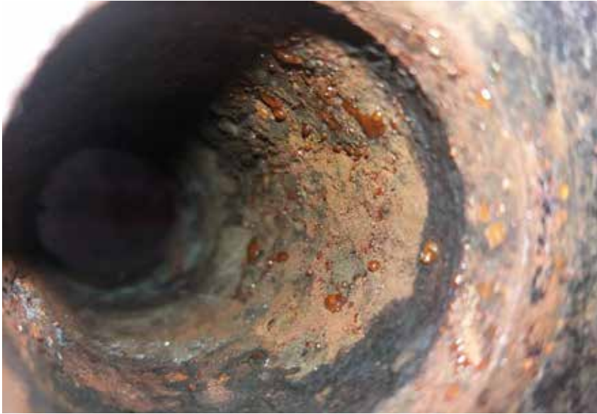
Figura 6.37 – Tubulação de água produzida
