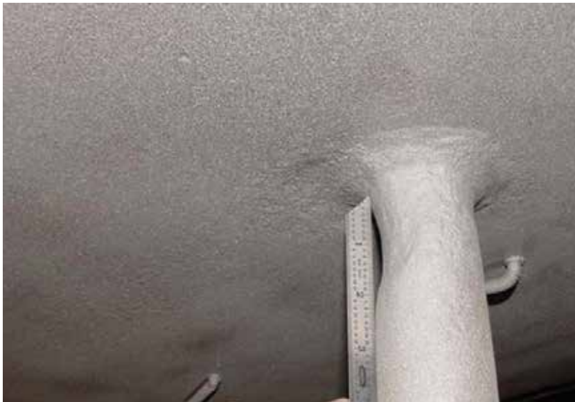
Figura 6.8 – Corrosão sob isolamento presente em um bocal no tampo inferior
