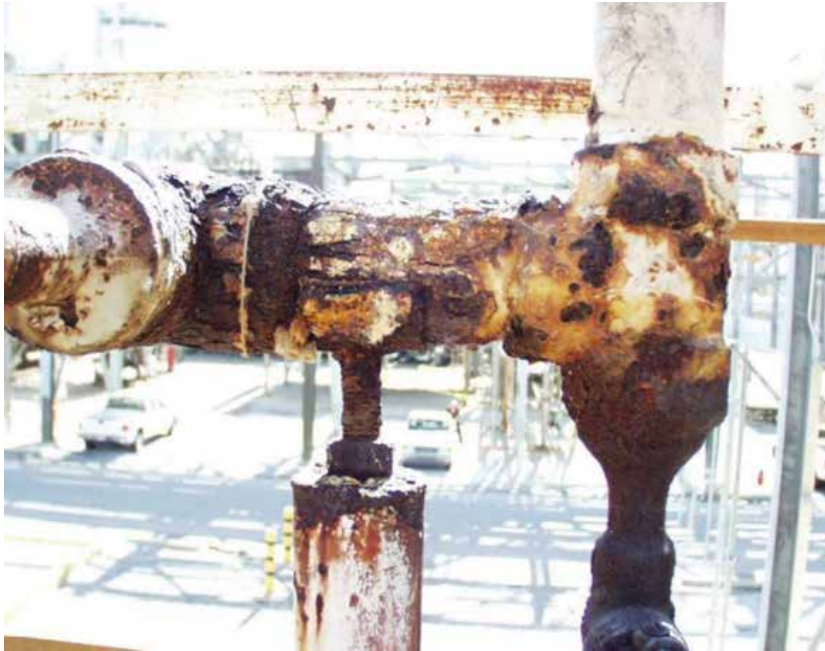
Figura 6.11 – Corrosão em um limitador de nível em aço-carbono
