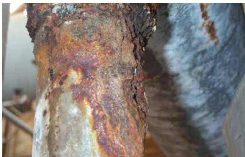
Figura 6.6 – Vista aproximada do processo de corrosão sob isolamento existente no "T" da figura 6.5 após remoção do isolamento
