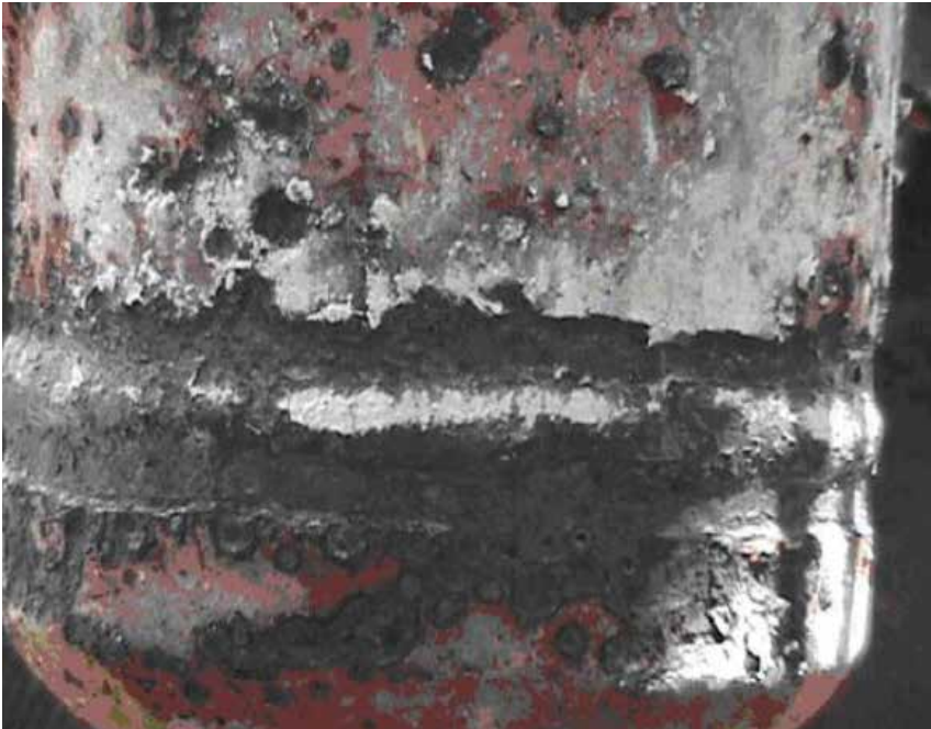
Figura 6.40 – Oxidação na superfície externa de uma linha de transferência de forno em aço-carbono
