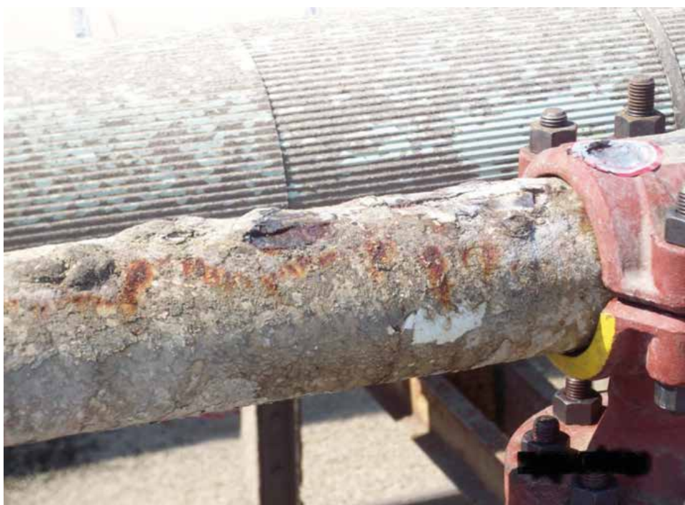
Figura 6.1 – Corrosão atmosférica em uma linha de GLP próxima a uma torre de resfriamento
