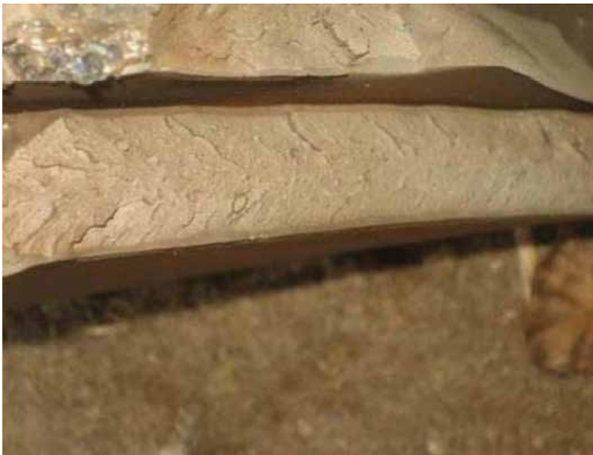
Figura 8.10 – Vista aproximada da superfície de fratura de um vaso fabricado em aço A516-70N mostrando as marcas de chevron que apontam na direção da origem da trinca
